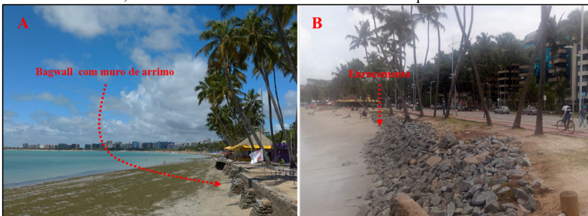
Figura 9 – Localidades com estruturas de contenção. A: Bagwall na Praia de Sete Coqueiro em 2020; B - Enrocamento no fim da Praia de Sete Coqueiros em 2019.
