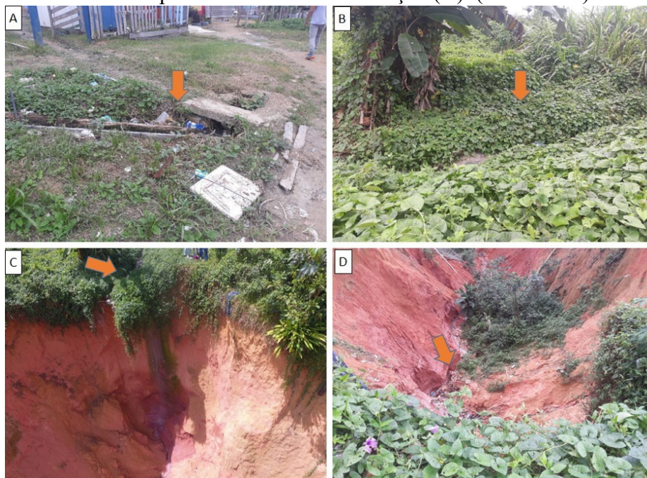
Figura 10 - Drenagem de água pluvial e esgoto residencial (A-B) para voçoroca (C) formando caminhos preferenciais dentro da feição (D). (Maio/2019)
