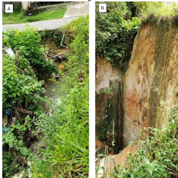
Figura 6 - Sulco à montante da cabeceira da voçoroca canalizando água da chuva e servidas - Maio/2019 (A); Escoamento do sulco convergindo na cabeceira da incisão - Maio/2019 (B)
