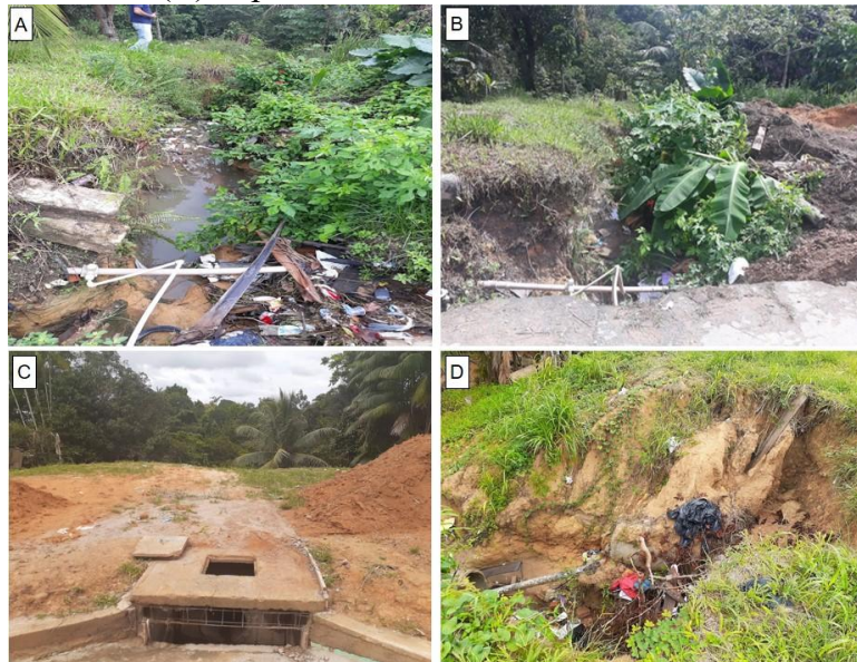
Figura 7 - Área à montante da incisão antes do aterro - Maio/2019 (A); existência de sulco à montante da cabeceira em Julho/2019 (B); aterro com construção de caixa coletora em Dezembro/2019 (C); Aprofundamento do sulco em Dezembro/2019 (D)
